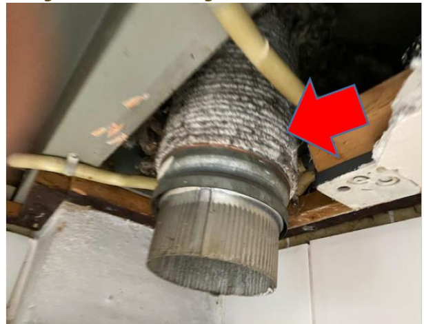
Figuur 2 asbestkoord: niet-hechtgebonden
